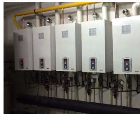
Calderas para ACS
