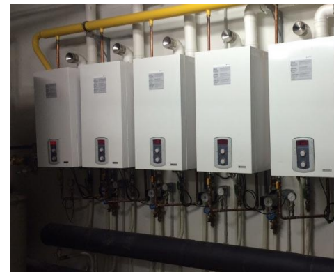
Calderas para ACS
